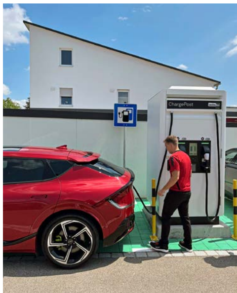
Bauherr Rössler vor Ladesäule
